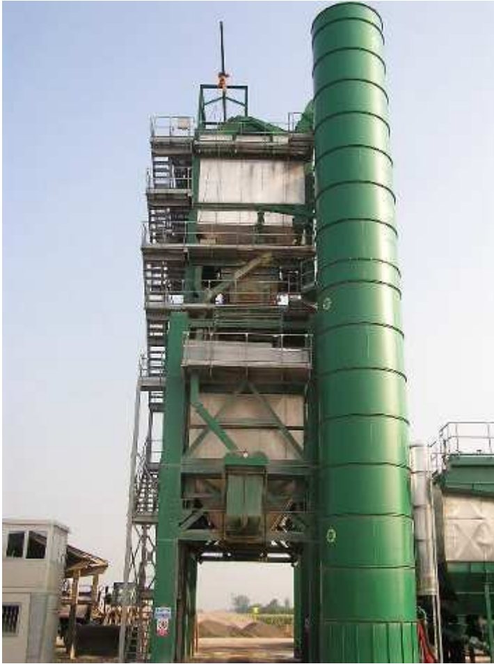
Figura 2-9 –Torre di miscelazione.
