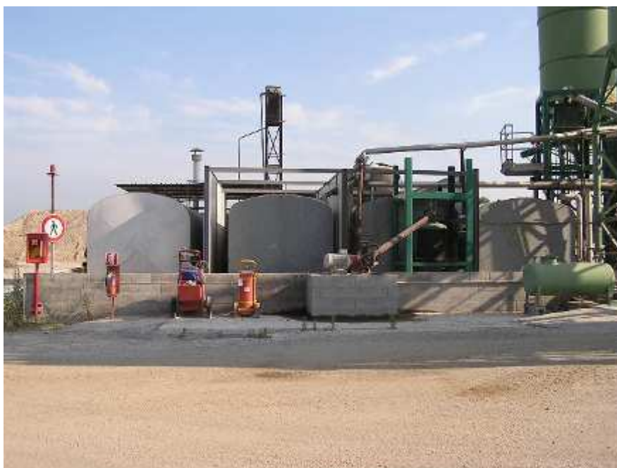
Figura 2-4 – Stoccaggio bitume nello stabilimento di produzione.
