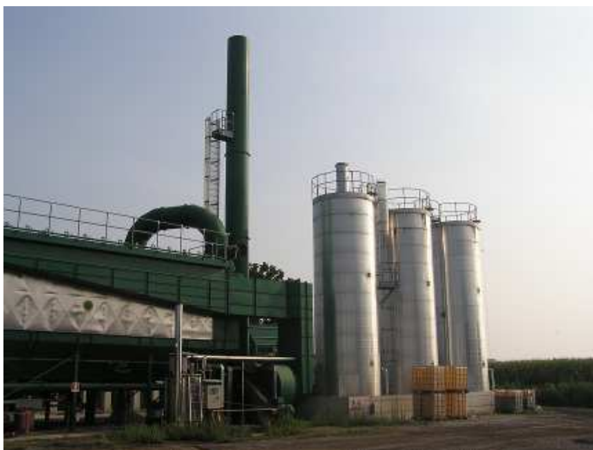
Figura 2-3 – Stoccaggio filler nello stabilimento di produzione.
